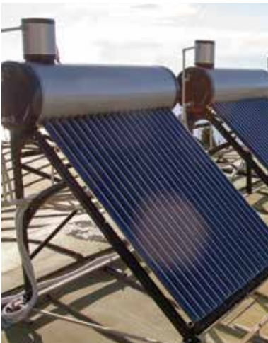
太陽熱温水器 実績塗料 ソーラーペイント（GSP-1・GSP-2）
