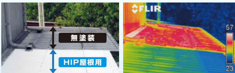
【表面温度比較 サーモグラフィで撮影】
