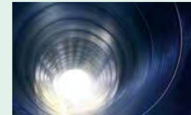
ダクトの内面
